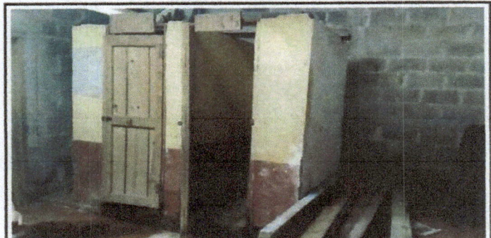
Foto 6: Se observa deterioro y daños mayores en el area de baños de la escuela y puertas deterioradas.
