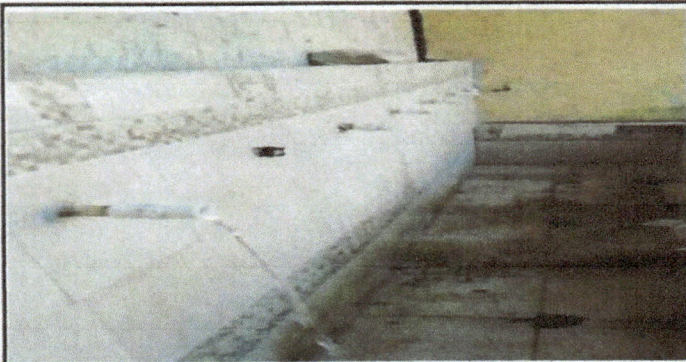
Foto 3: Se observa la falta de llaves de agua en el area de lavamanos.
