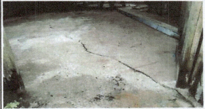
Foto 2: Se Observa agrietamiento en la superficie del piso, daño en el piso del modulo de preprimaria.
