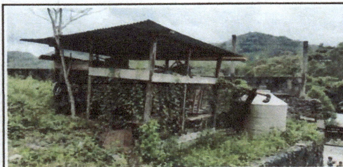
Foto 5: Se observa daño en el deposito de agua, daño en la base que sostiene el deposito de agua.
