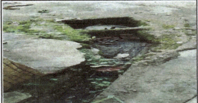
Foto 4: Se observa deterioro en el sistema de aguas fluviales lo que provoca que el agua ingrese a algunos modulos.
